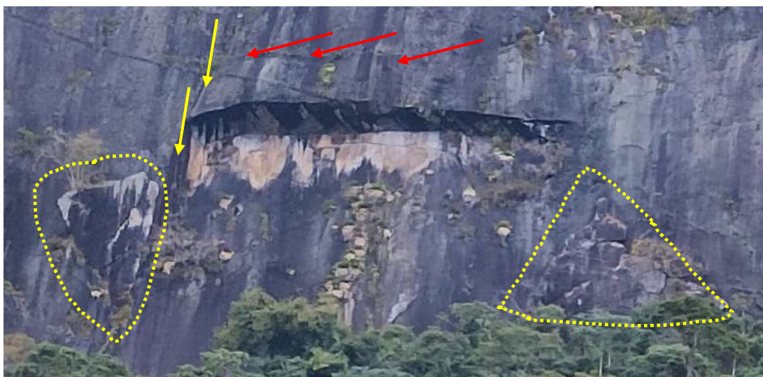
Figura 8 – Linha pontilhadas amarelas circundando lascas verticais. Setas amarelas indicando fratura vertical e setas vermelhas fratura sub-horizontal com cruzamento com fratura de alívio permitindo individualização de bloco rochoso.
