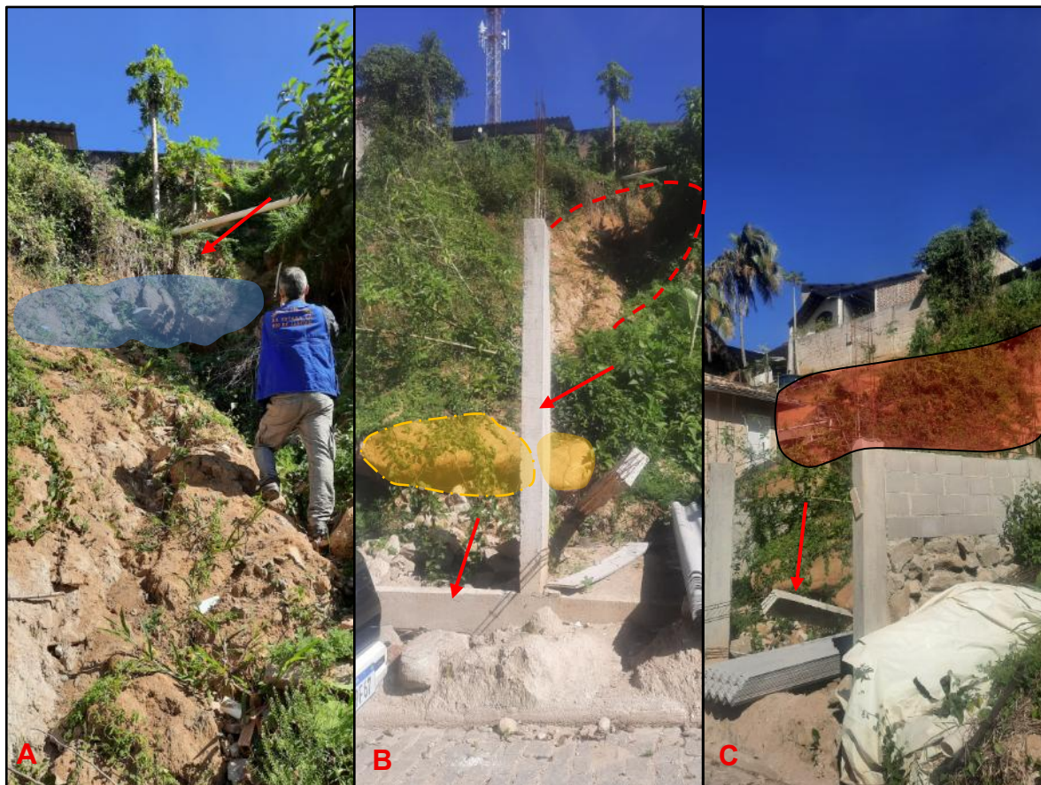
Figura 3 – Ponto 1 - A – Face frontal do talude, seta em vermelho indica ponto do desprendimento do matacão; Área hachurada em azul – zona de blocos parcialmente enterrados no solo; B – Em laranja blocos que desprenderam-se e assentaram-se na base do talude; Setas em vermelho colunas e alicerces atingidos pelos matações; C – Setas em vermelho estruturas em alvenaria (colunas) afetadas e colapsadas, pela queda e rolamento dos blocos; hachurado em vermelho requer monitoramento do talude, base das residências desse local, devem ser monitoradas sistematicamente- porção de jusante das casas – Vista de jusante pra montante a partir da rua João Batista Ribeiro ao lado do nº 277 - Glicério – Macaé RJ
