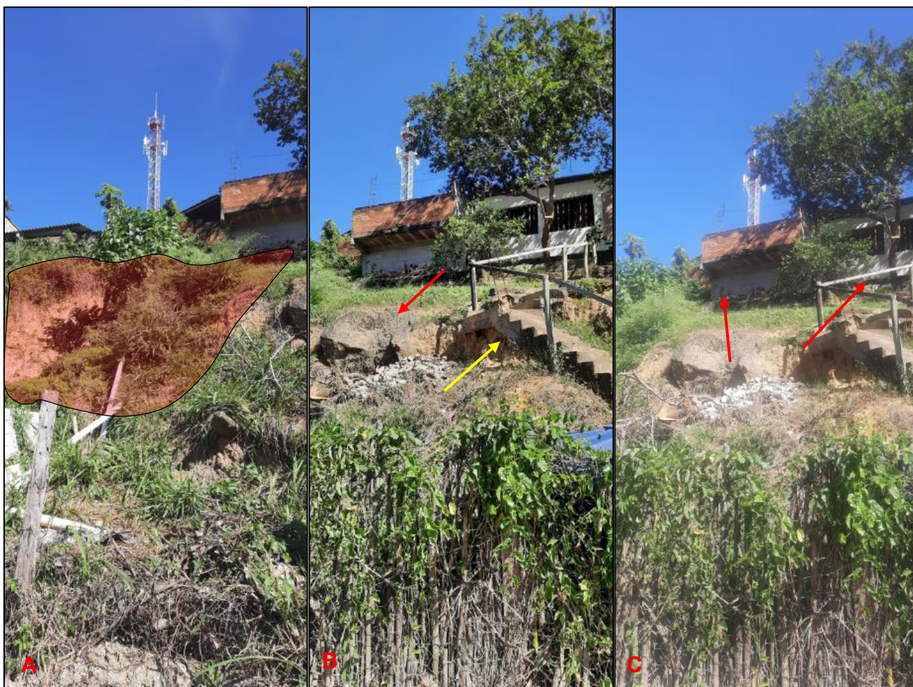
Figura 4 – Ponto 2 - A – Face frontal do talude, hachurado em vermelho recomposição dessa porção do talude (sugestão); B – Seta em vermelho indica matacão métrico, comuns nessa porção frontal do talude; seta amarela indica escada sob risco, descalçamento da base de sustentação; C – Casas desse local - setas em vermelho devem ser monitoradas sistematicamente- porção de jusante das casas – Vista de jusante pra montante a partir da rua João Batista Ribeiro ao lado do nº 327 - Glicério – Macaé RJ
