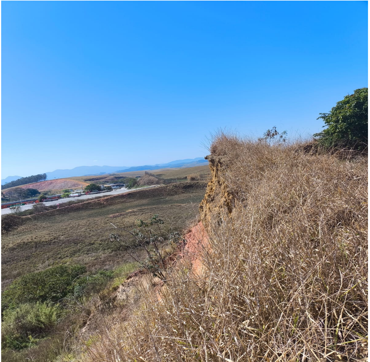
Foto 4: Ângulos negativos do talude.
