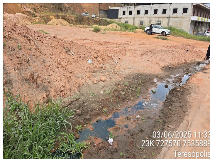
Figura 09: Acúmulo de resíduos líquidos (esgoto) junto a base do talude.
