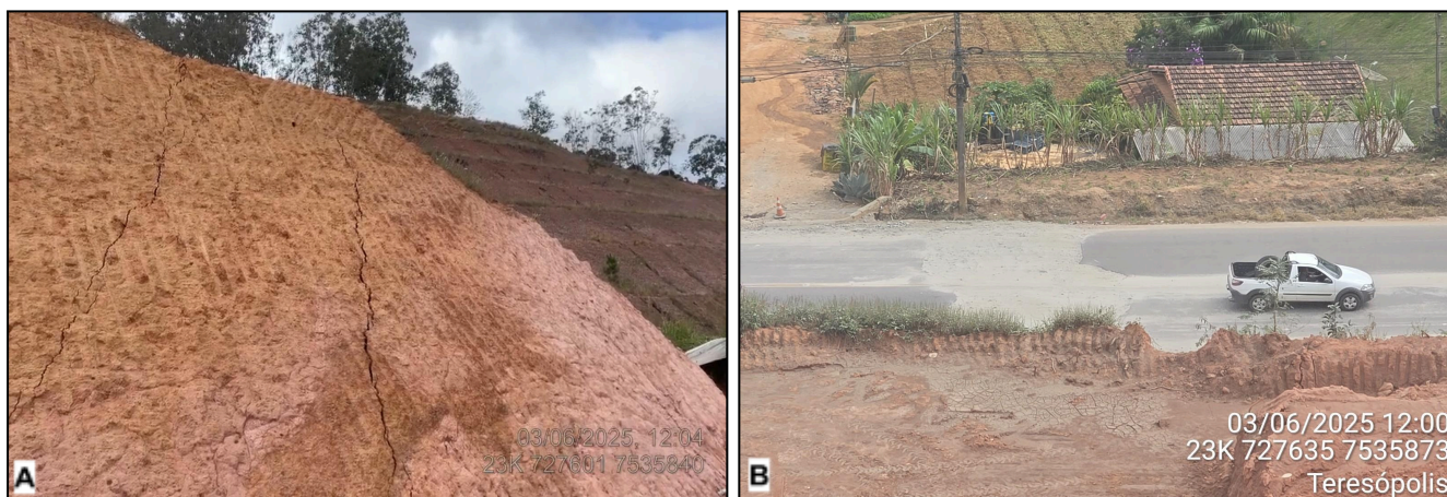
Figura 06: A) Trincas sub paralelas ao possível trajeto da movimentação; B) trecho de asfalto com cimentação recente, ocultando a trinca. Detalhe para a visualização de trinca aparentemente contígua a ocultada.
