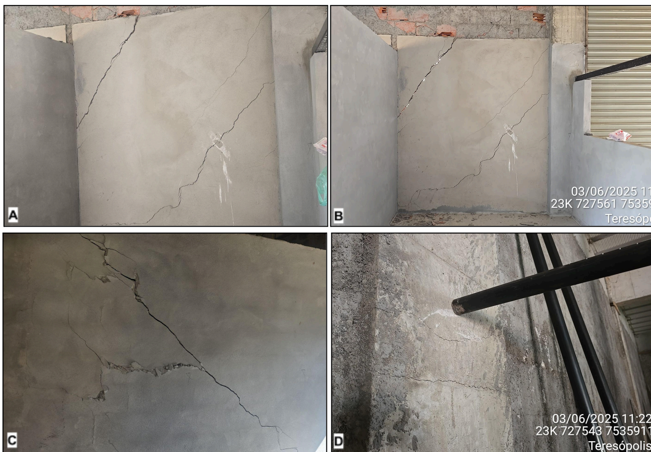
Figura 08: Feições de instabilidade estrutural das edificações a jusante: A e B ) evolução das trincas e rachaduras diagonais em um período de uma semana; C ) trincas diagonais com ramificações visíveis; D ) fissuras em coluna de uma das edificações, onde há abaulamento de alvenaria.
