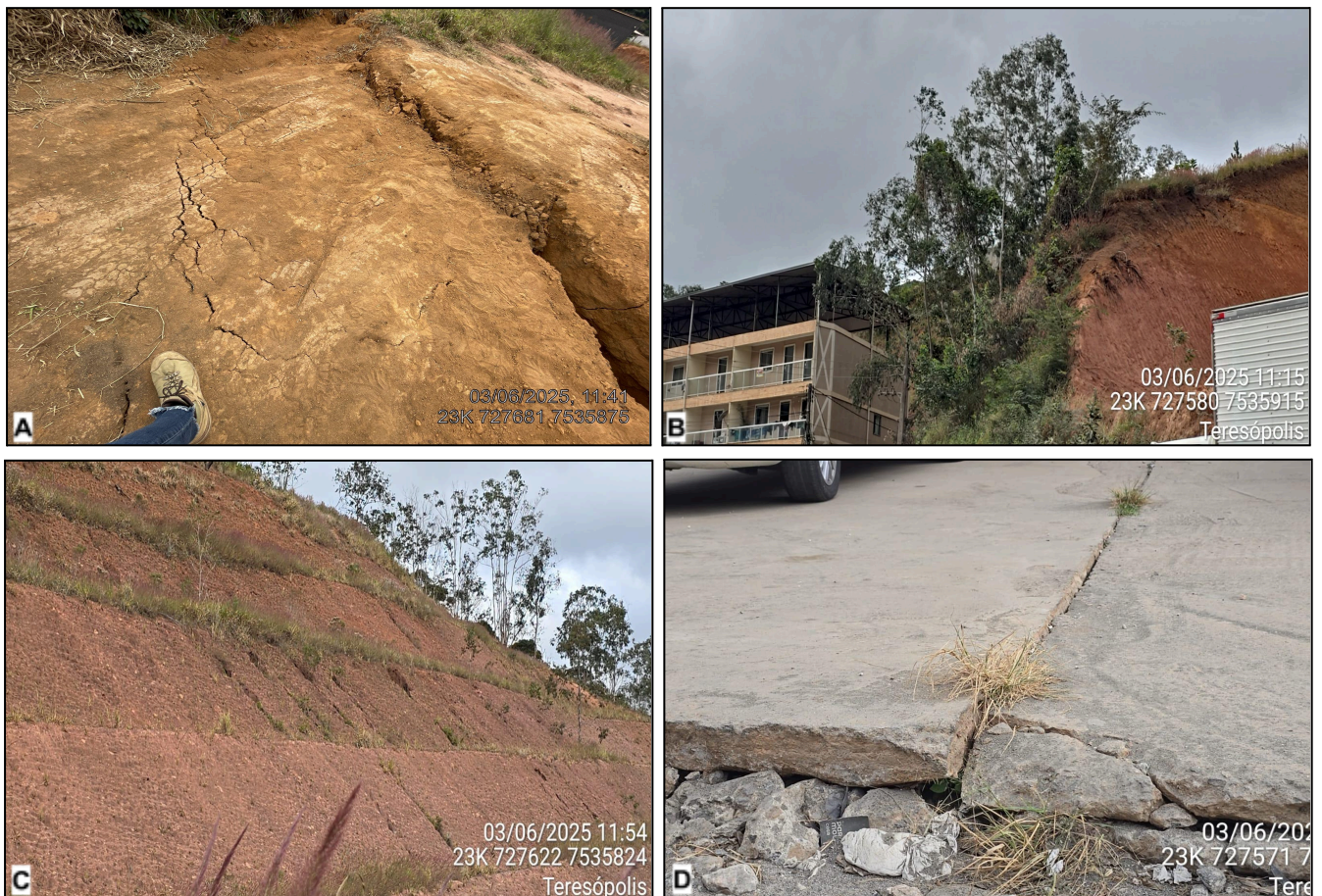
Figura 07: Feições de instabilidade no setor: A) trincas sub paralelas a trinca mais desenvolvida; B) espécies arbóreas tombadas; C) processos de ravinamento em talude sub verticalizado; D) desnivelamento de passeio público.
