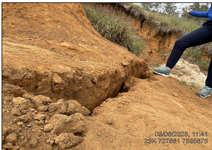
Figura 05: Degrau de abatimento identificado a montante dos taludes escalonados.
