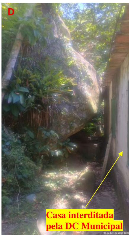
Figura 5 – P2 – C – Setas em vermelho rachadura em bloco rochoso atrás da residência, objeto da nossa vistoria. Não foi informado pela DC ou moradora, se a rachadura aumentou sua abertura; D – Mesmo bloco, posiciona-se “colado” na casa interdita. Sugere-se seu desmonte parcial com argamassa expansiva.
